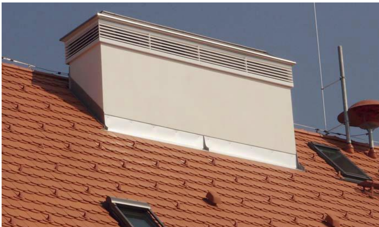
Obrázek 17 Nasávání větracího vzduchu je provedeno pomocí rozměrné atypické hlavice na střeše budovy, esteticky připodobněné k tradičnímu komínu
